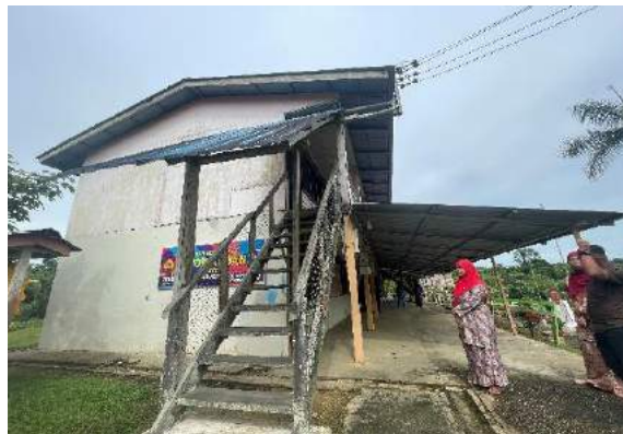
Keadaan bangunan bilik kelas sekolah (05.02.2024) (Sumber: PAC Parlimen)
