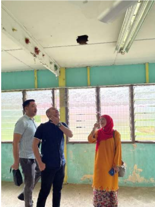
Keadaan siling kelas berlubang akibat reput (05.02.2024) (Sumber: PAC Parlimen)
