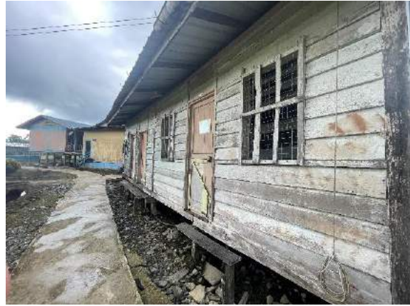
Keadaan blok bangunan sekolah usang dan rosak (05.02.2024) (Sumber: PAC Parlimen)
