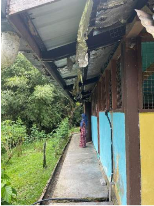
Kedadaan siling dewan makan sekolah rosak (05.02.2024) (Sumber: PAC Parlimen)
